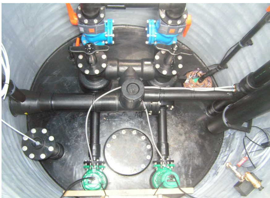
Vnitřní prostor čerpací stanice
